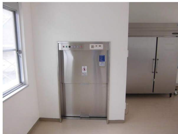
水巻中学校配膳用リフト
