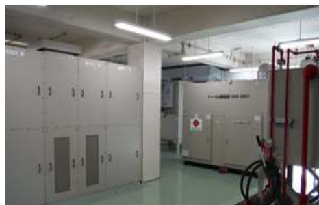
《高松汚水中継ポンプ場（電気室）》
