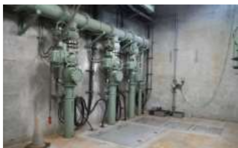
《高松汚水中継ポンプ場（ポンプ井）》
