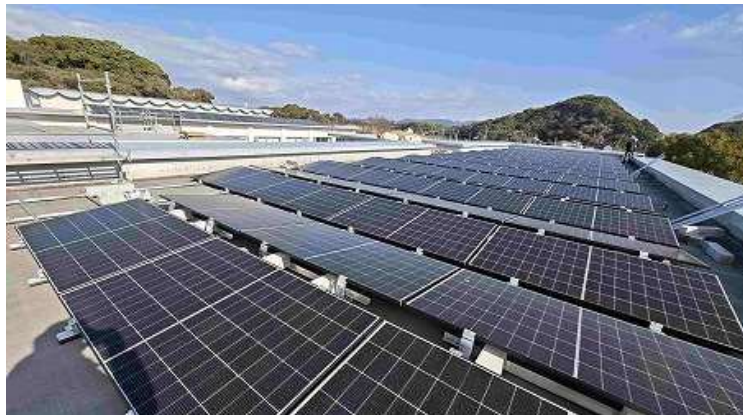
吉田小学校屋上に設置した太陽光発電設備
