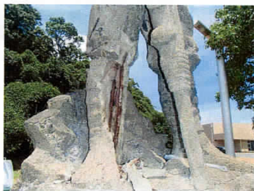
右足の鉄筋の錆(2017年補修時)
