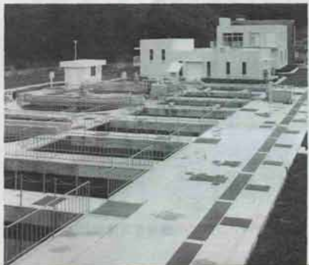
●高松下水処理場
